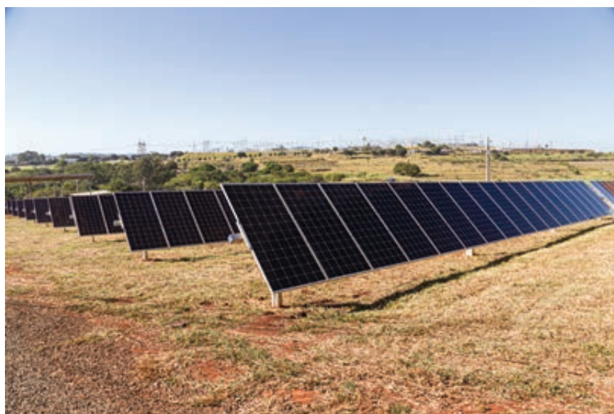
Usina solar da BYD BYD solar plant
